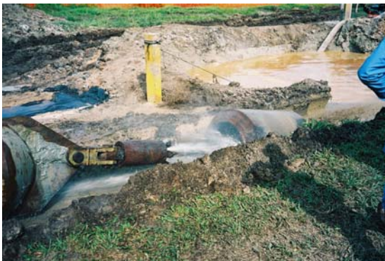
Início Entrada do Tubo
